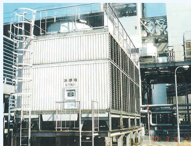
大型クーリングタワー
