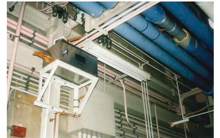
SW設置場所
