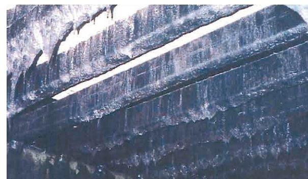
スケール付着がひどく配管が見えない
