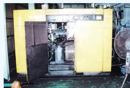
コンプレッサー
