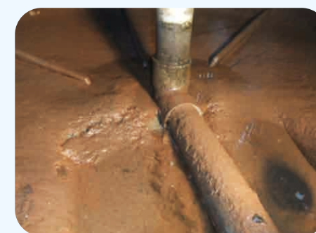
CT底部に堆積したスケール
