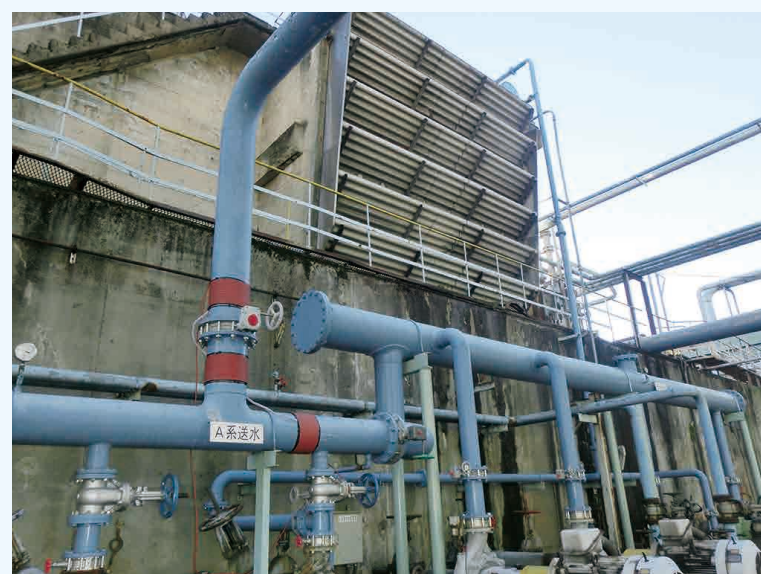
配管に設置されたSWコイル(赤色)部
