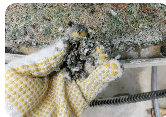
軟化剥離したスケールの確認
