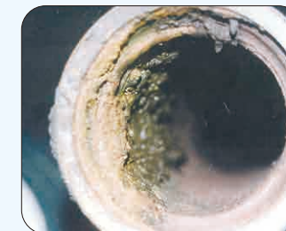
水平配管下側に 軟質物が堆積していた
