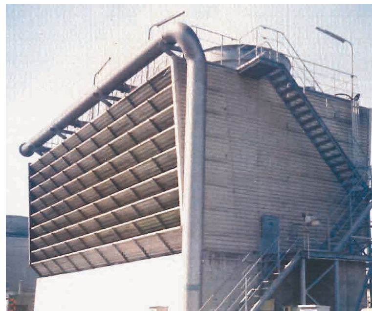
大型クーリングタワー
