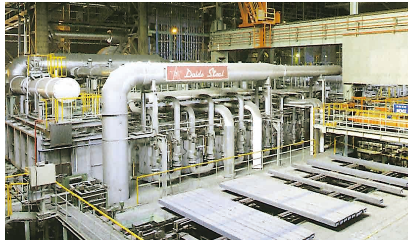
冷却水300A配管
