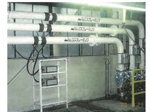
SW設置場所
