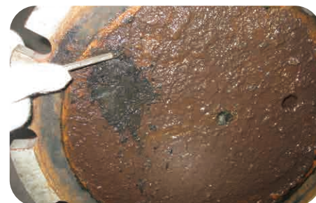
フタ部分錆の軟化確認
