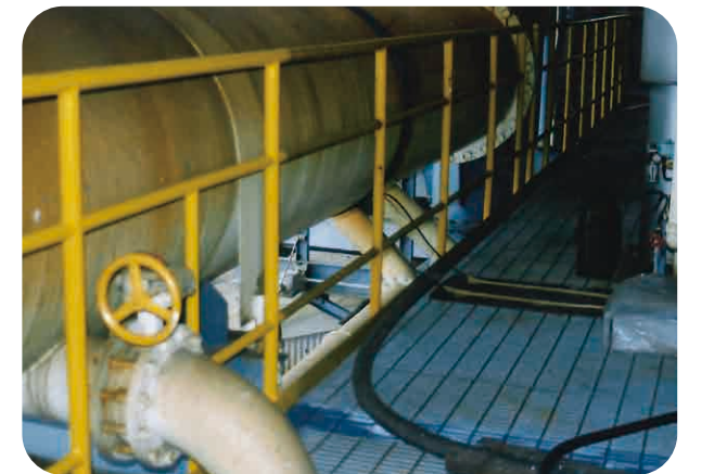
SW設置配管
