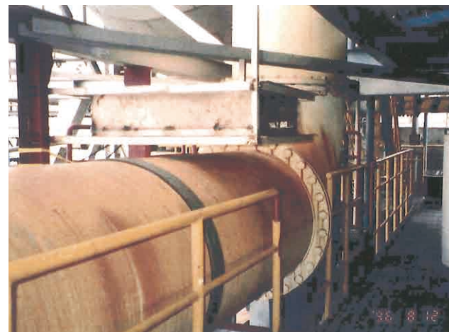
配管口径及び材質 1,100φ SGPゴムライニング
