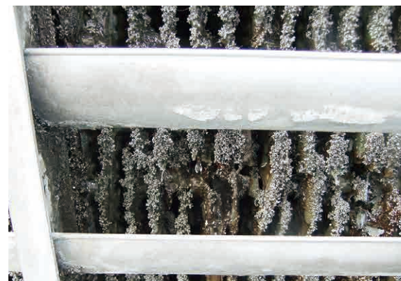
水の流がまったく見えない程スケールが付着している
