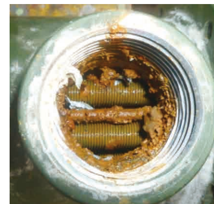
熱交換器内部
