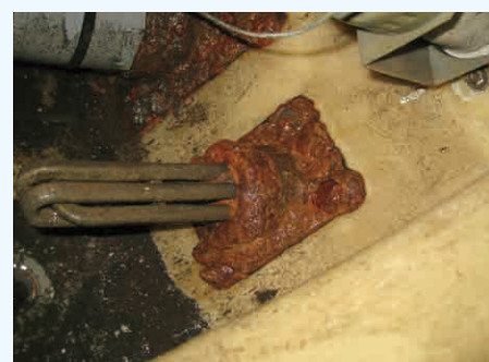
錆の固着状況
