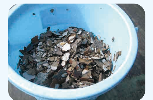
回収された剥離物
