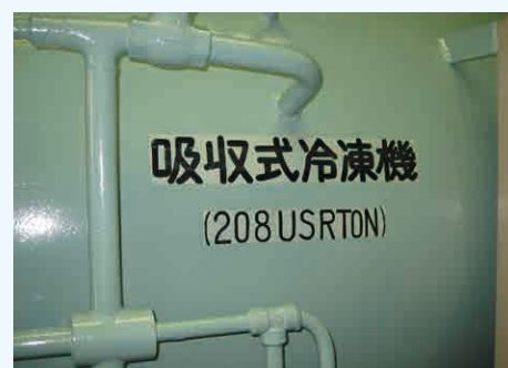
吸収式冷凍機
