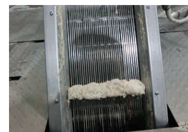
現状は油脂の固まりのみ
