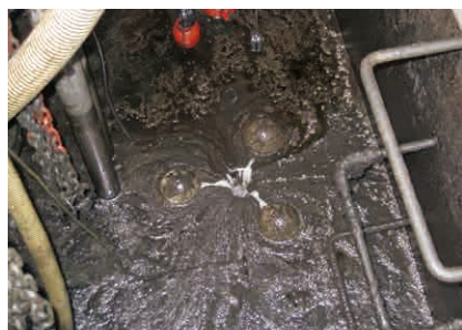
水面に厚く堆積した黒色油
