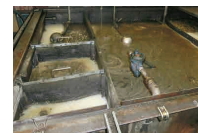
設置前 液面は非常に汚れている
