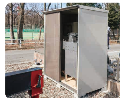
スチール製収納庫内に設置したB-COS 20M
