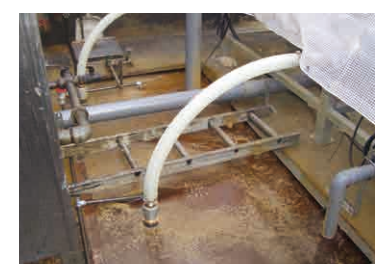
油が堆積したピット
