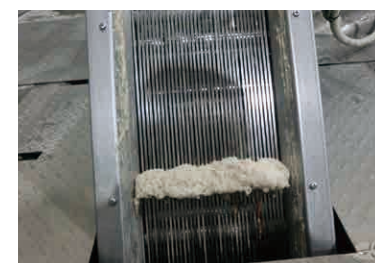
現状は油脂の固まりのみ
